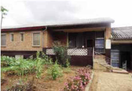
Nach 30 Jahren sanierungsbedürftig
